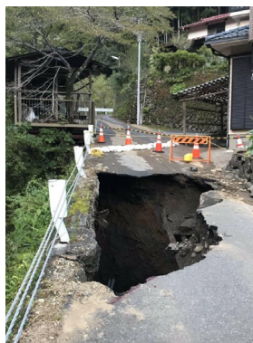
▲奥多摩町の棚澤地区。 道路が崩落しています。 (10月13日時点)
